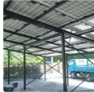
在柱子下方保留空間的施工案例 The case of using long posts to make a space
